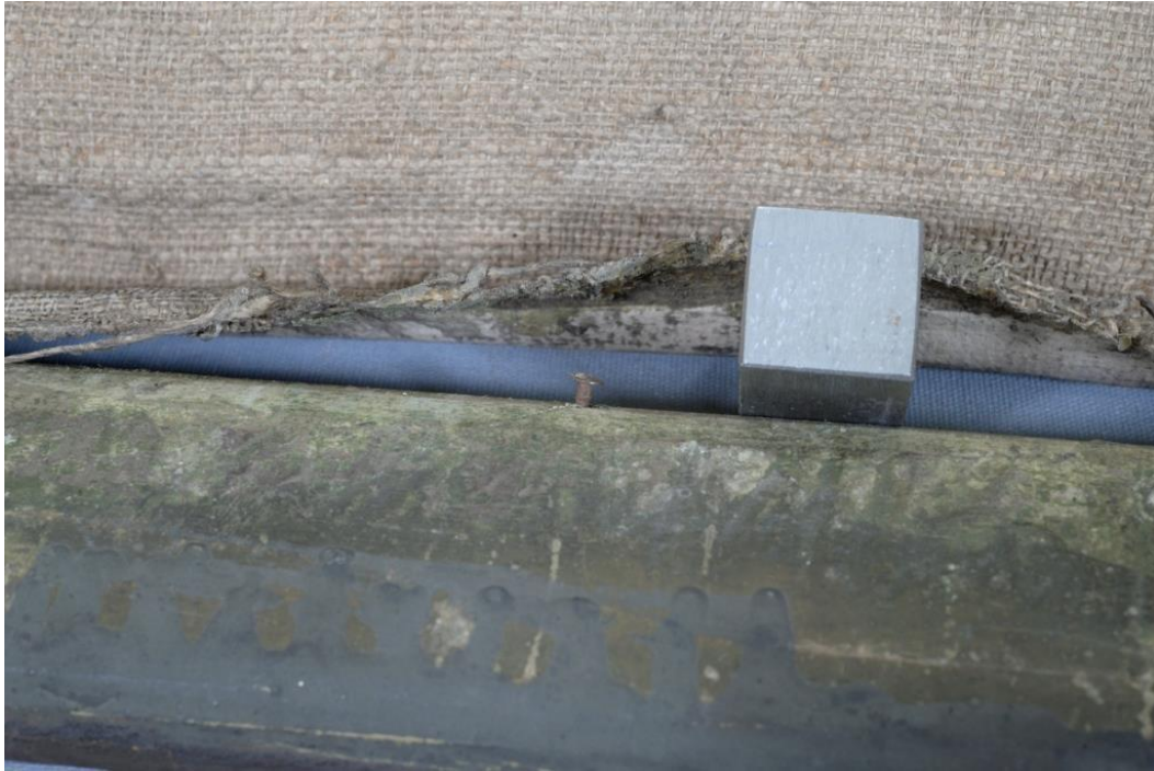
Parziale distacco del bastone superiore
